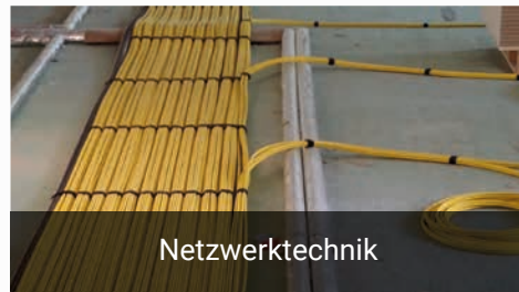
Stark- und Schwachstrom
